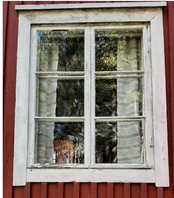
Ikkunat ovat ulkopuolelta siistimisen tarpeessa.
